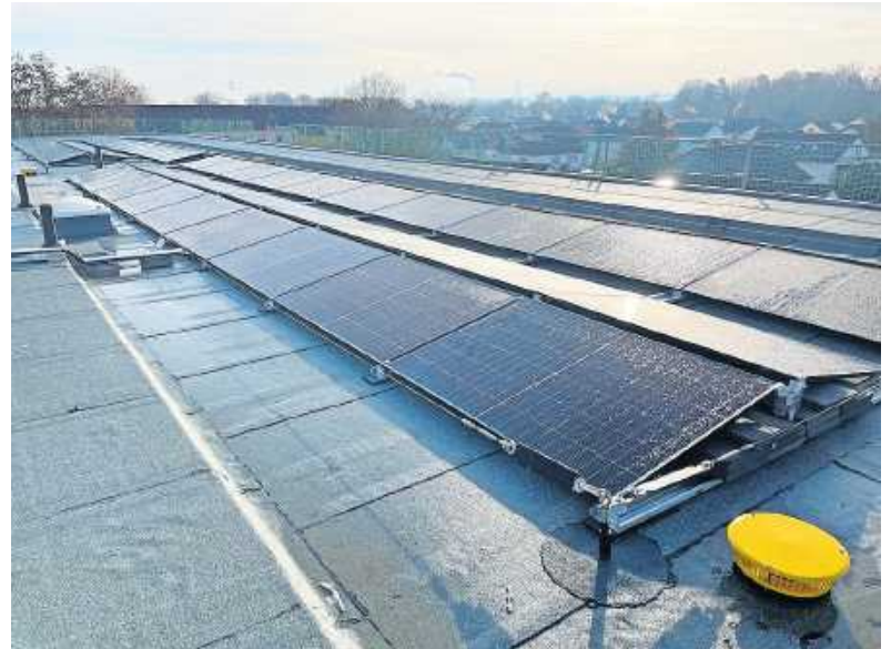
Blick auf die neu errichtete Photovoltaikanlage auf einem Wohnhaus in der Dorschbergstraße 25-27 (Foto: Neue Energie Wörth)
